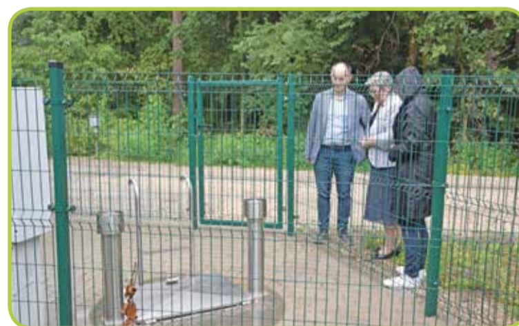
Pompownia ścieków w Wiszni Małej na ulicy Przy Dębie
